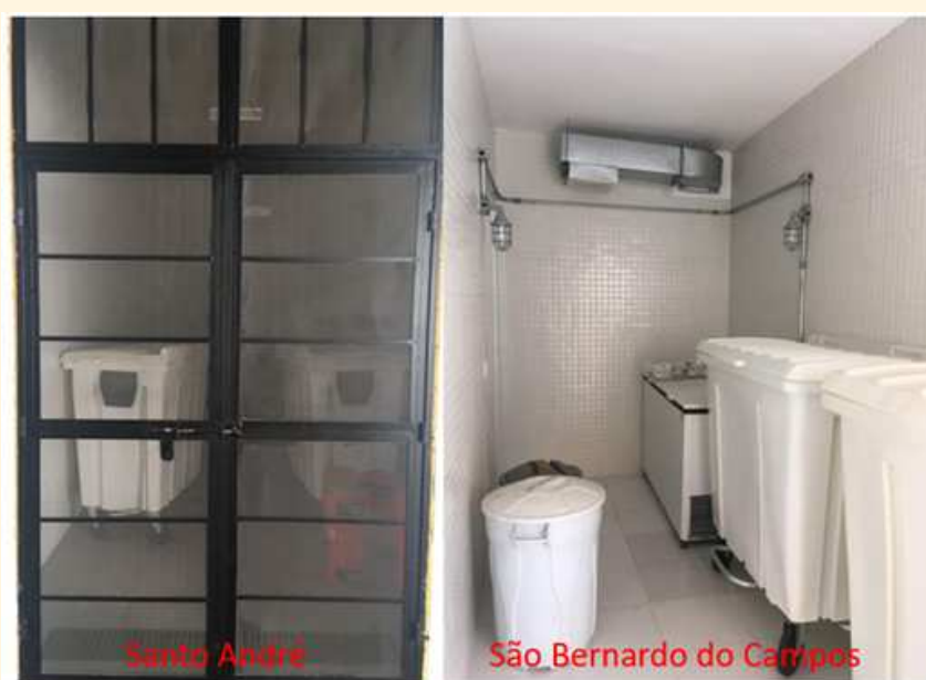
Figura 11: Exemplo de abrigos temporários de resíduos infectantes/perfurocortantes nos campi
