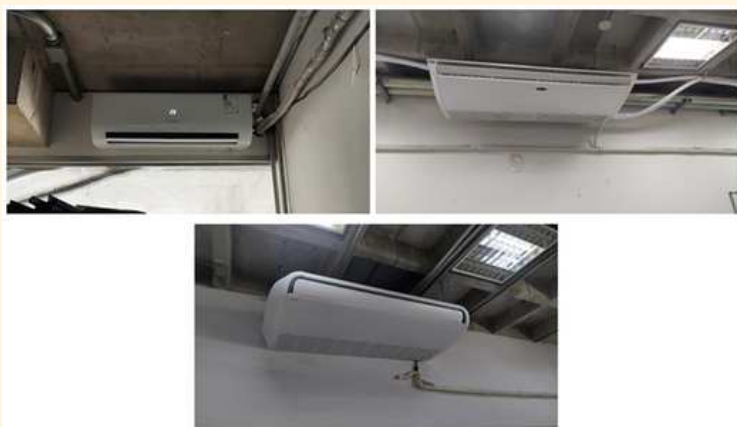
Figura 1: Máquinas novas de modelo inverter (mais eficientes) instaladas com o projeto
