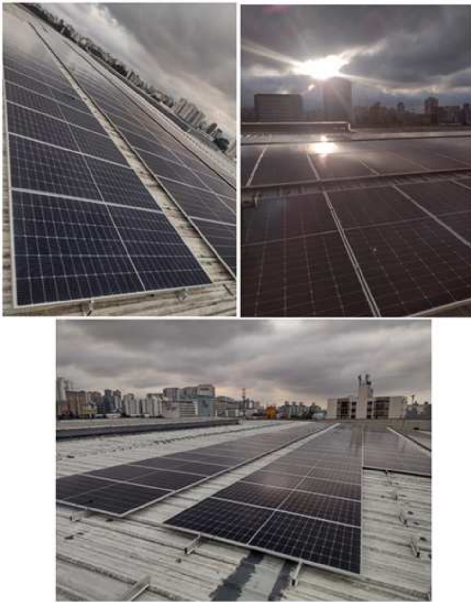
Figura 8: Sistema fotovoltaico no telhado do Ginásio Poliesportivo do Bloco E
